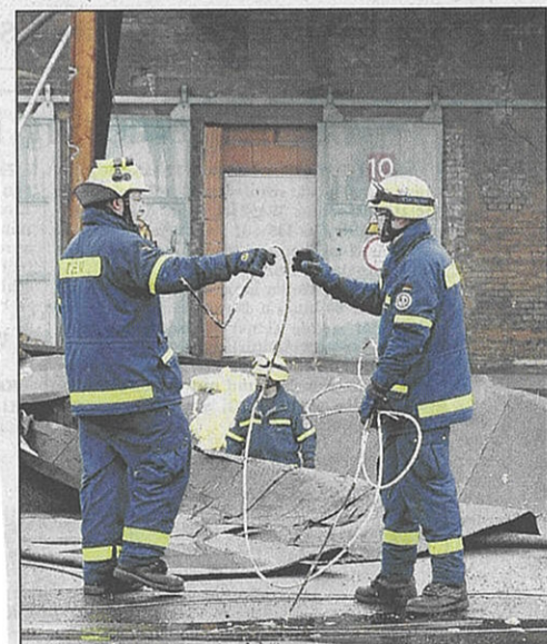
Im Einsatz: Mitglieder des Technischen Hilfswerks räumten die Trümmer weg.
